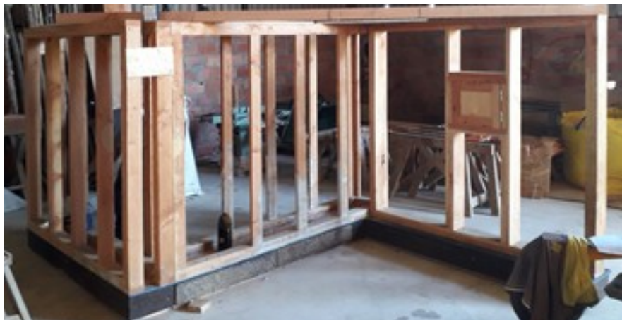
Le déploiement de notre maquette de formation « Pro Paille » nécessite un espace de 5m par 2,5m au sol.
