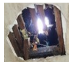
Le trou dans la toiture de la serre
