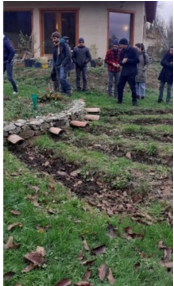
Filtres à broyat de bois pour l'épuration des eaux grises à Brassac
